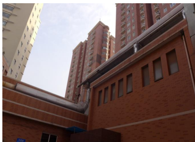
图：锅炉烟气管
