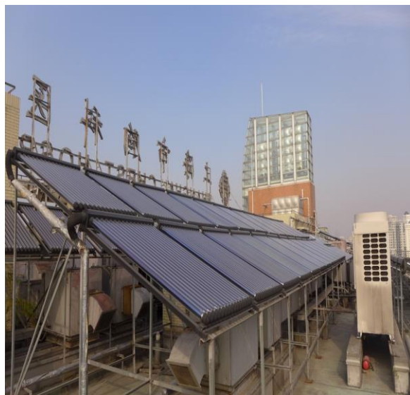
图：屋顶太阳能集热器
