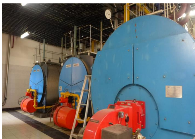
图：改造后锅炉房实景图
