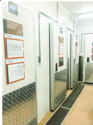
Sector de refrigeración
