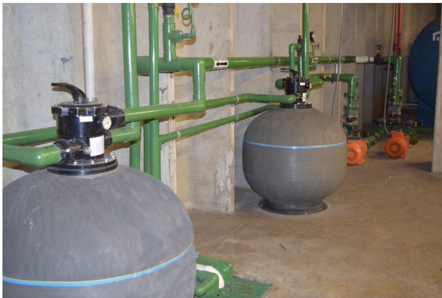
Filtros de arena para proceso filtración agua lluvia
