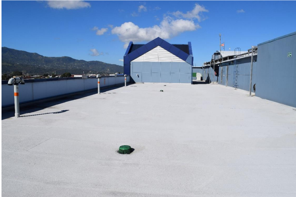
Captación de agua de lluvia en azoteas
