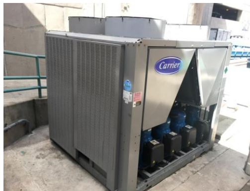
Central de agua helada, Edificio de Especialidades Médicas
