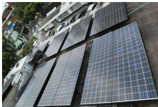
Paneles fotovoltaicos instalados
